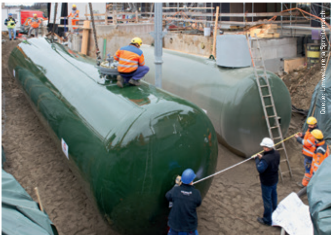
Abb. 4: Zwei große Druckbehälter zur H 2 -Speicherung
