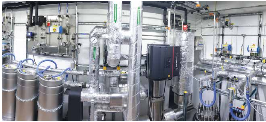
Abb. 6: Innenansicht des 500-kW-Green-Electrolyzers [Quelle: iGas]
