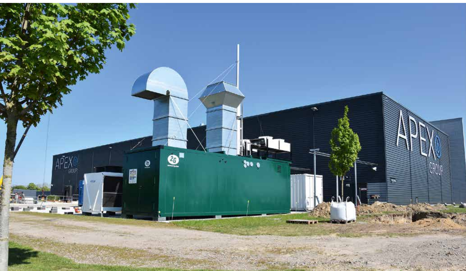
Abb. 3: Aufbau des Wasserstoffkraftwerks mit einem H 2 -BHKW von 2G bei Apex
