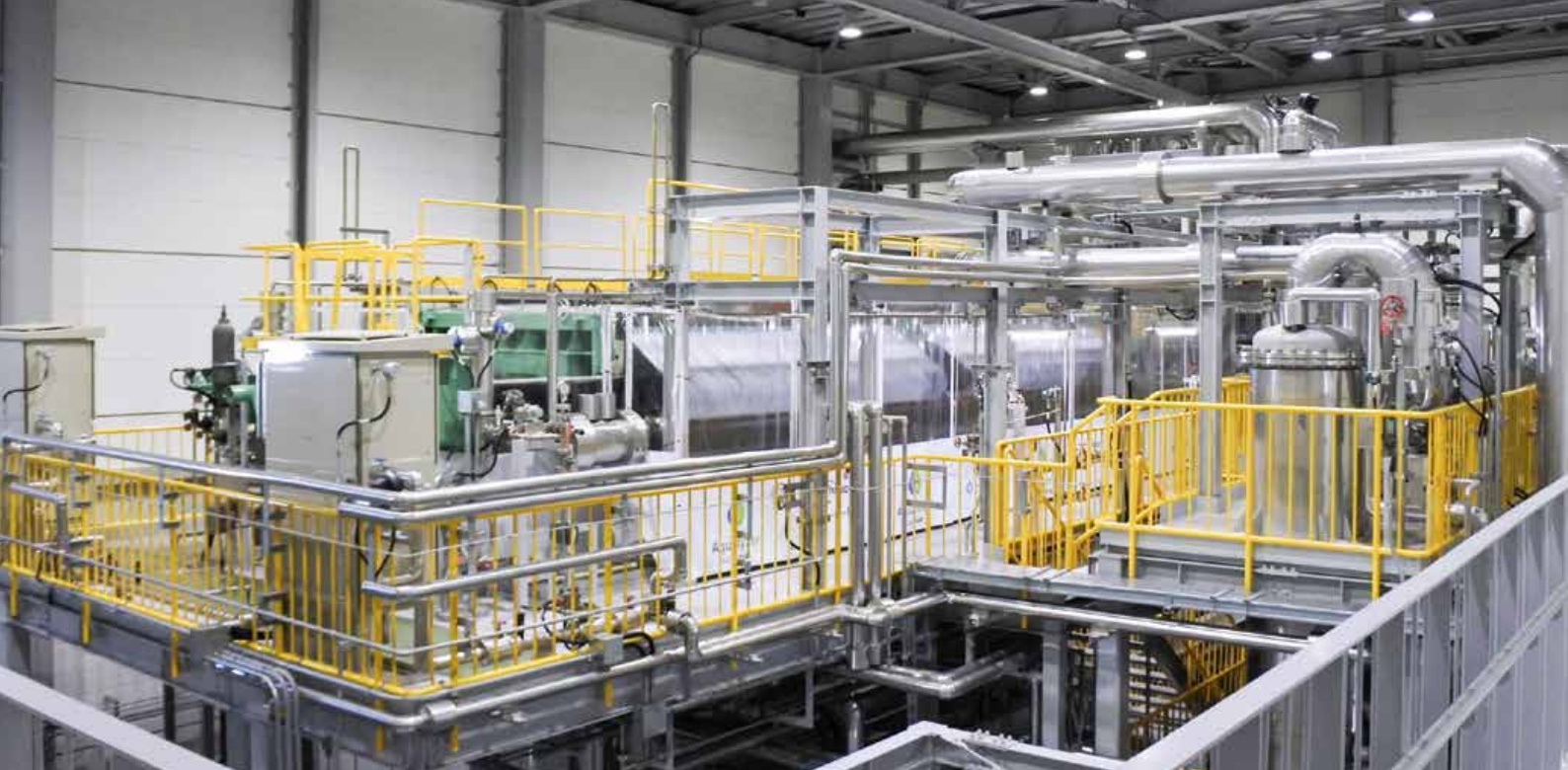
Abb. 3: Im März 2020 nahm Asahi Kasei den Betrieb seines 10-MW-Alkali-Elektrolyseurs in Namie, Fukushima, Japan, auf – des größten Single-Stack-Systems der Welt (1.200 Nm 3 grüner Wasserstoff pro Stunde) [Quelle: Asahi Kasei]
