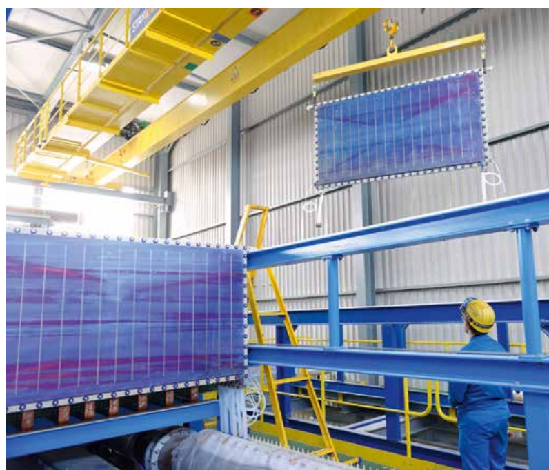
Abb. 4: Module für die alkalische Wasserelektrolyse (AWE) bei thyssenkrupp [Quelle: thyssenkrupp]
