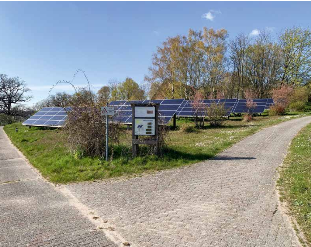
Abb.: Diese Freianlagen steht als kleine Demoanlage seit rund 20 Jahren auf der Naturschutzinsel Vilm: Heute wäre die Leistung auf gleicher Fläche 2,5-mal so groß. Die Kosten liegen heute mindestens 90 Prozent unter den Kosten von damals. [Quelle: K.-H. Remmers]
