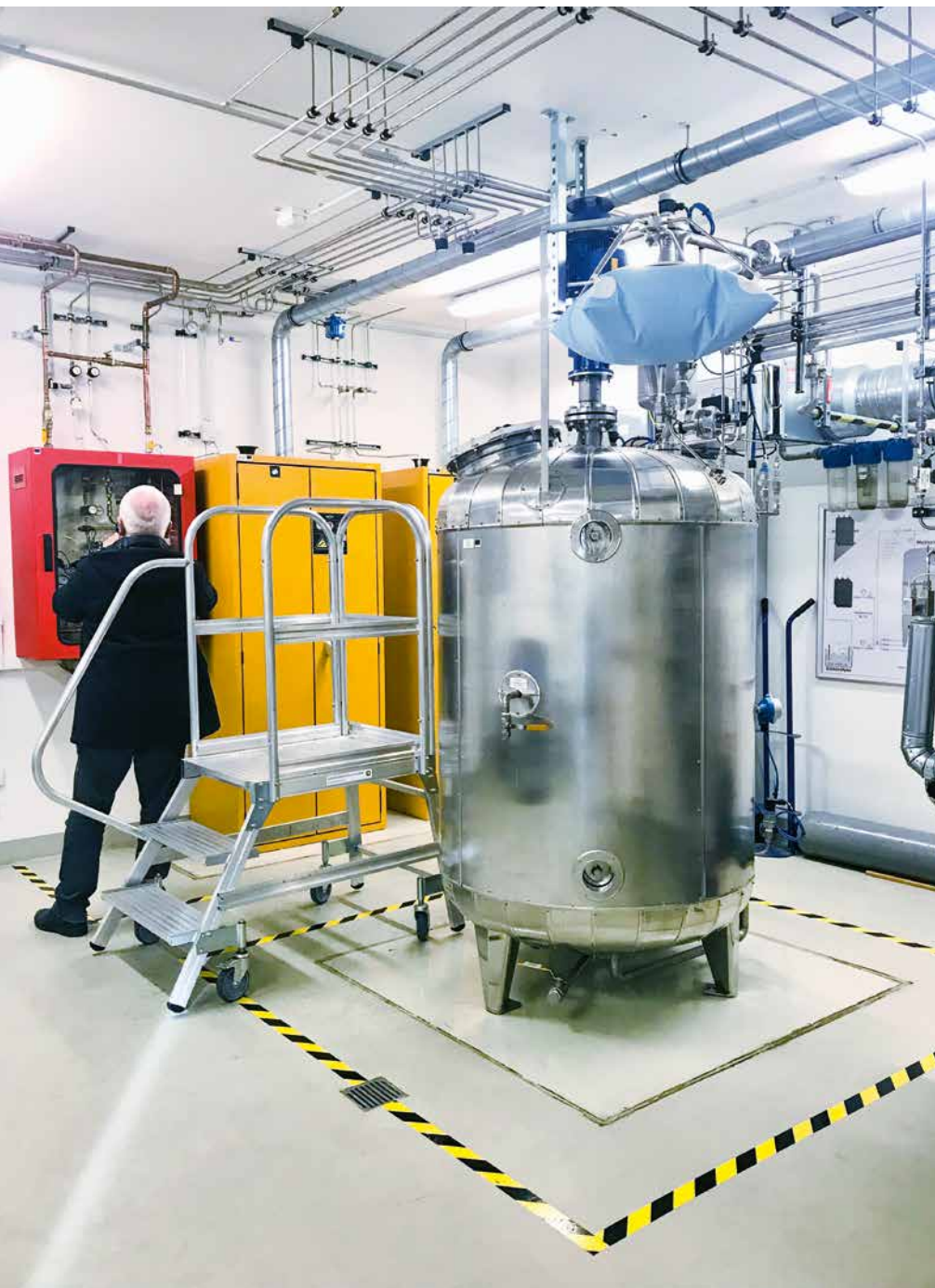
Abb. 3: Methanisierungsanlage im CC4E
